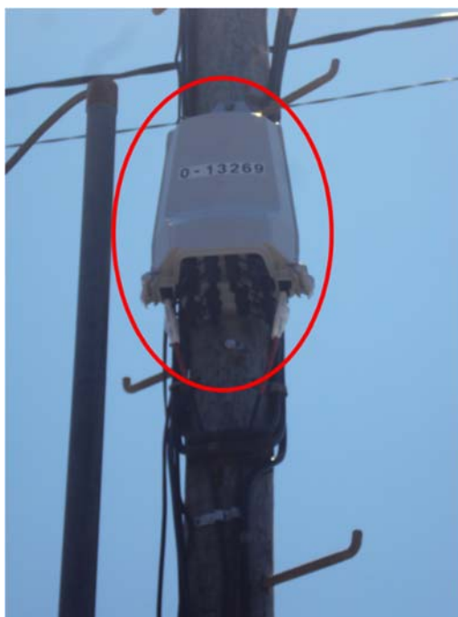
Ilustración 21. Caja terminal óptica (CTO) instalada en Poste.
