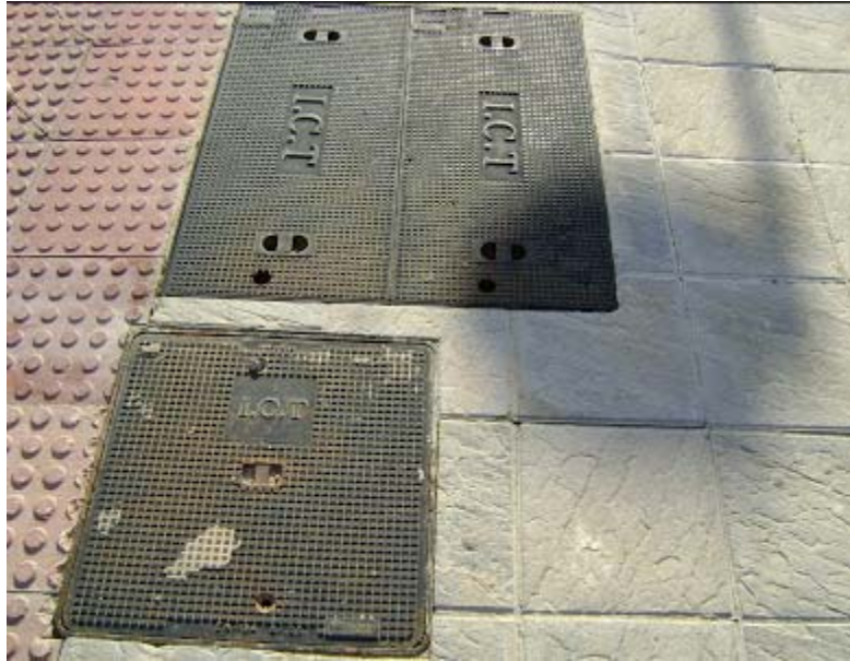
Ilustración 14. Arqueta de entrada a edificio con despliegue interior.
