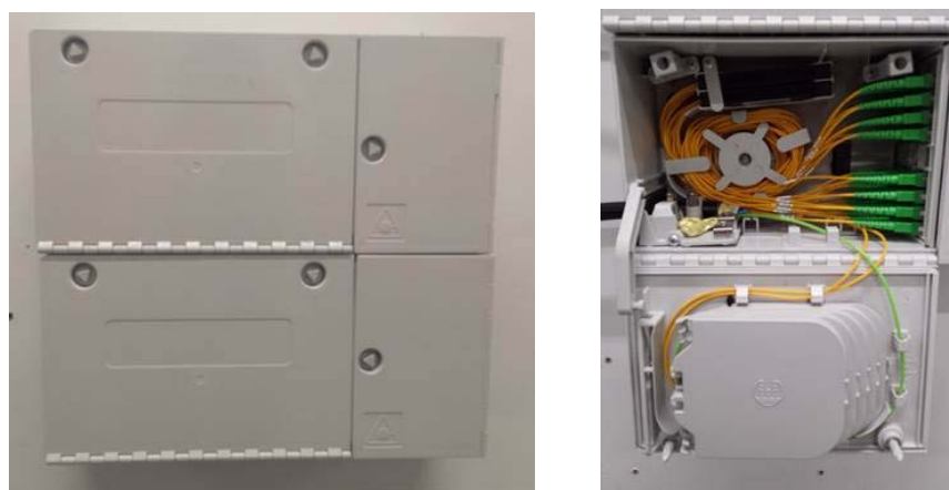
Ilustración 16-2. Caja terminal óptica (CTO) interior, con tamaño y nº de usuarios reducido.
