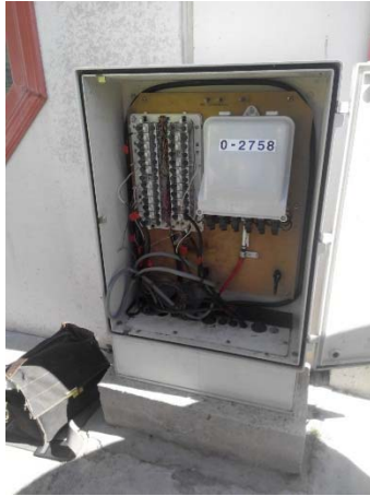
Ilustración 22. Caja terminal óptica (CTO) instalada en Pedestal.
