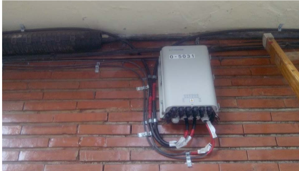
Ilustración 19. Detalle Caja terminal óptica (CTO) exterior.
